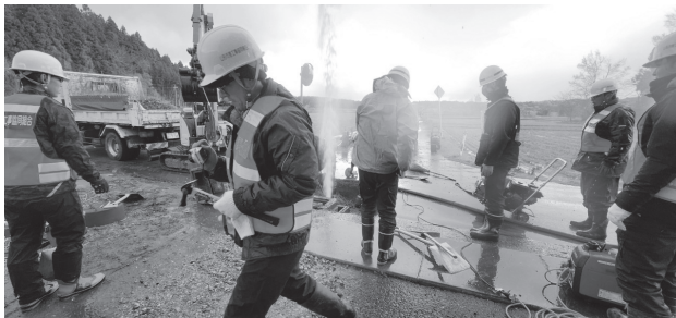
水道管破損状況(噴水状況)
